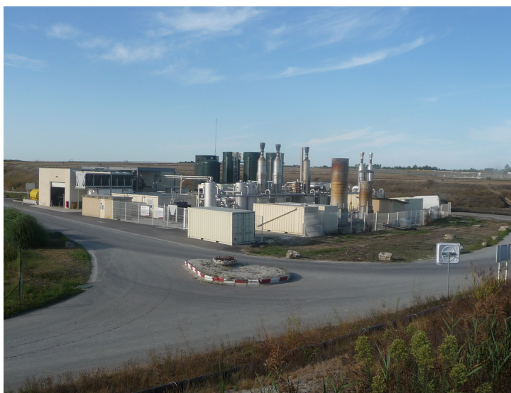
Centrale de méthanisation de Lapouyade (crédit photo : erea)
