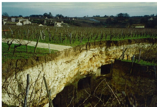
Vignoble et voie privée de Belair effondrés Crédit photos : Bureau des Carrières Souterraines CG 33
